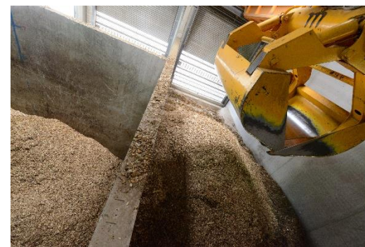
Stockage de combustible à la chaufferie bois d'Epinal
